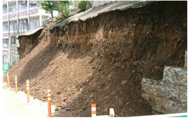
(b)崩壊後の様子
