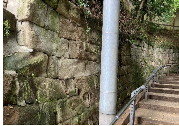
(b)変状後の修復の様子
