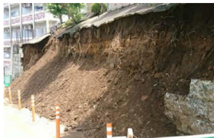
(b)崩壊後の様子
