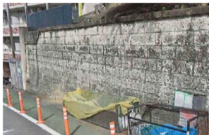
(a)健全な様子
