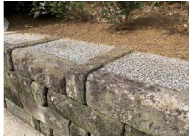
(a)健全な様子
